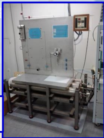
Almacenamiento H 2 70 Nm 3 /h
