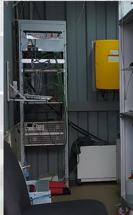
Cuadro comunicaciones Batería 5 kWh
