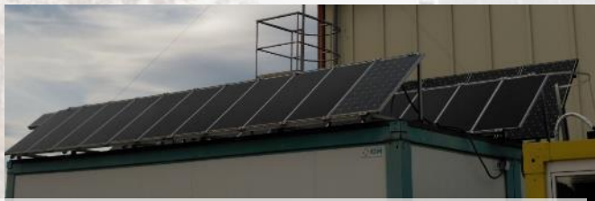
Dos grupos de paneles fotovoltaicos (PV) de 1,5 kWp cada uno, potencia total de 3 kW.
