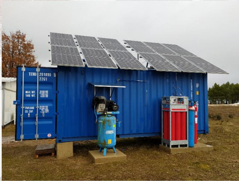
Conjunto de placas solares 4 kWp
